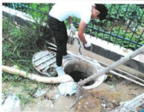
图七 FS3（污水总排口）
